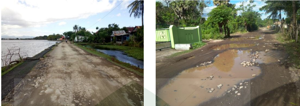
Gambar 9 Kondisi jalan di Desa Ujung Baji
