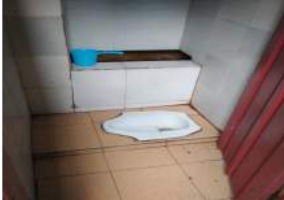
Kondisi jamban/WC pesantren Ummul Mukminin Putri
