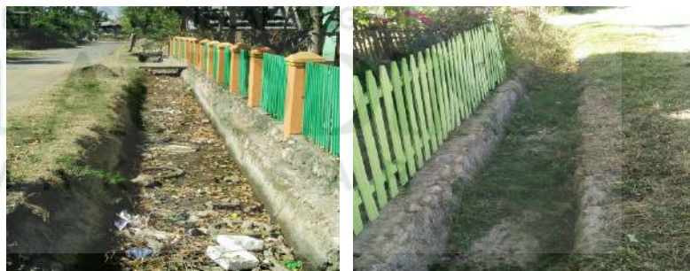
Gambar 4.32 Kondisi Drainase kampung Tekolabbua RW 01.
