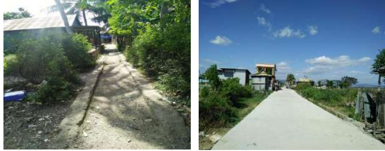
Gambar 4.30 Kondisi Jalan kampung Tekolabbua RW 01. Sumber : Survey Lapangan 2017
