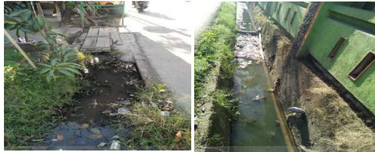
Gambar 4.4 Kondisi Drainase Kampung Lette Sumber : Survey Lapangan 2017
