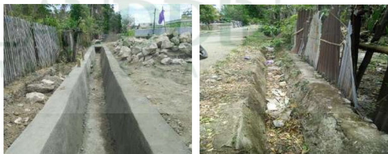
Gambar 4.73 Kondisi drainase kawasan kumuh Bonto Perak.
