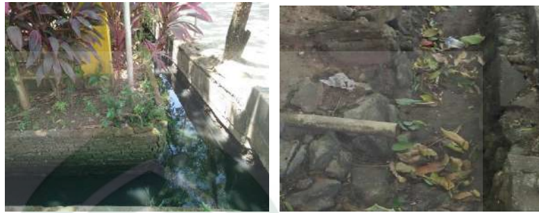
Gambar 4.14 Kondisi Drainase Kampung Tumampua Sumber : Survey Lapangan 2017
