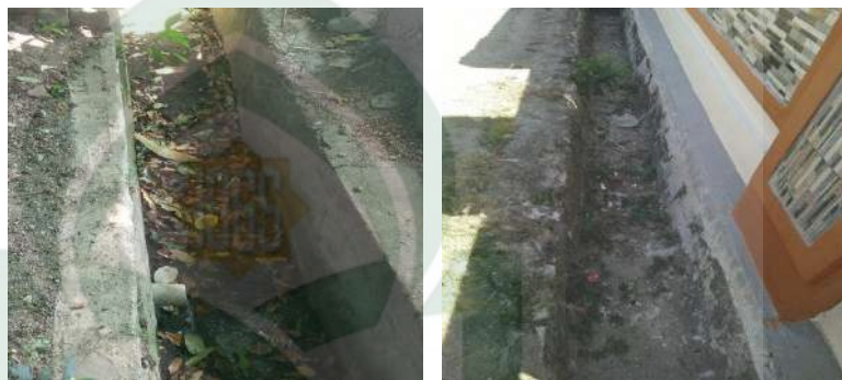
Gambar 4.23 Kondisi Drainase Kampung Paddoang-doangan.
