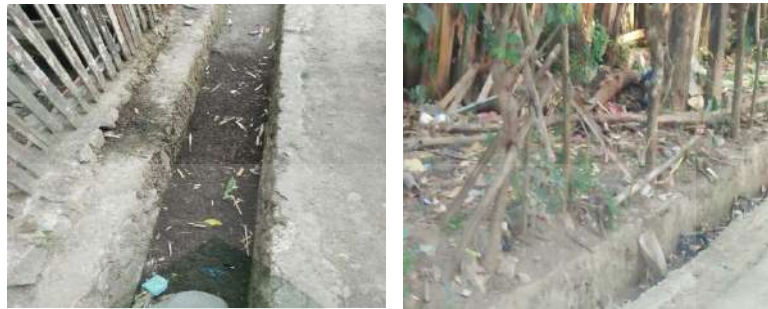
Gambar 4.56 Kondisi drainase kawasan kumuh Bonto Labbere.
