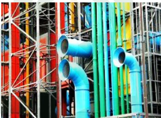
Gambar II.34 Sistem utilitas Pompidou Centre (Sumber : http://www.kompasiana.com/ , diakses pada 01 April 2014)
