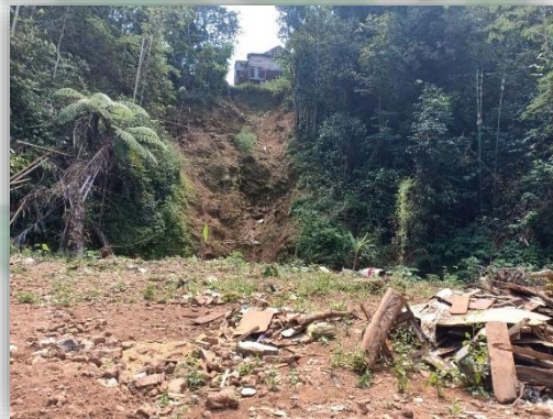
Gambar 4.13 Kerusakan Rumah di Kelurahan Malino
