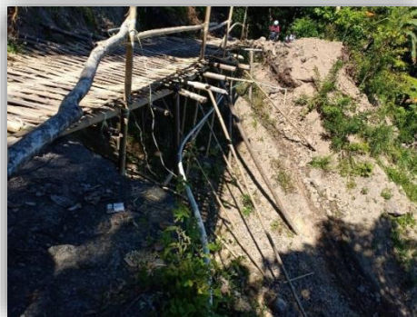
Gambar 4.12 Kerusakan Jembatan di Kelurahan Gantarang
