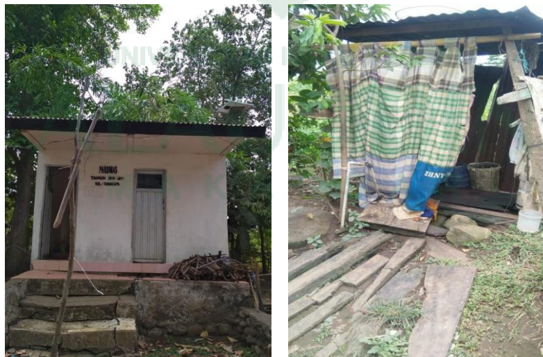
Gambar 21 Kondisi MCK di Kmapung Romang Tangaya
