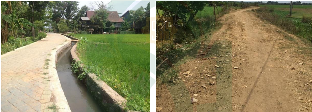
Gambar 15 Kondisi Jalan di Kampung Romang Tangaya
