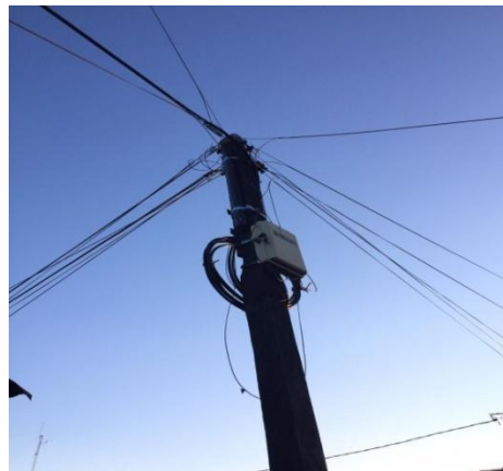
Gambar 28. Kondisi Jaringan listrik dan telekomunikasi
