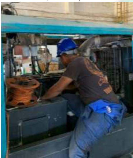
Mesin Bor: untuk memperbaiki alat-alat yang mengalami kebocoran.
