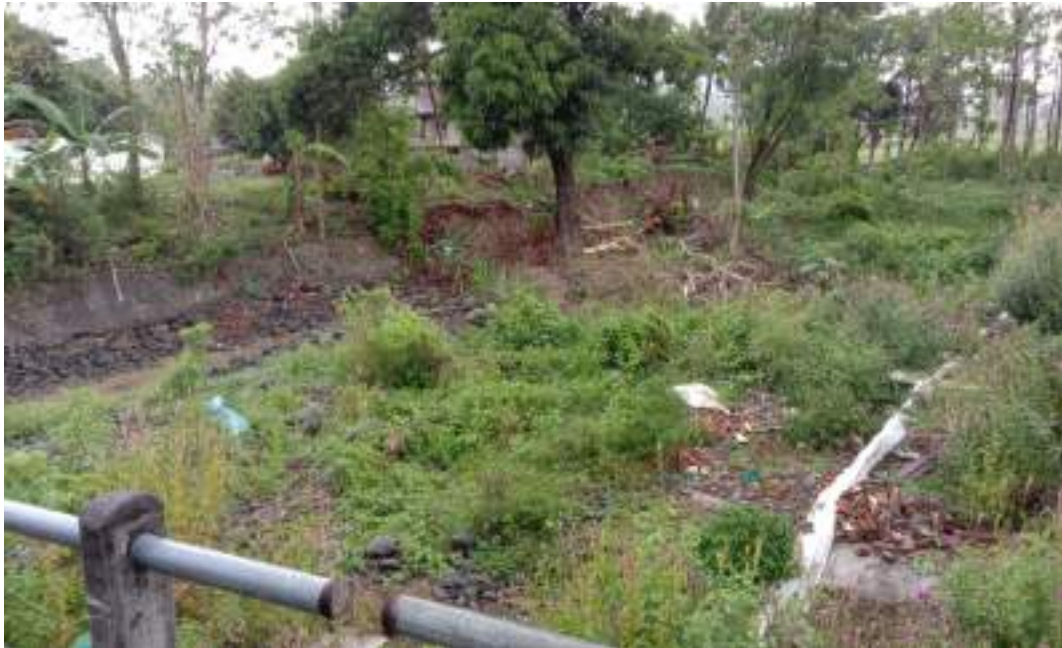
Kondisi Sungai Cabbue yang mengalami kerusakan tanggul dan belum adanya kegiatan normalisasi sungai.
