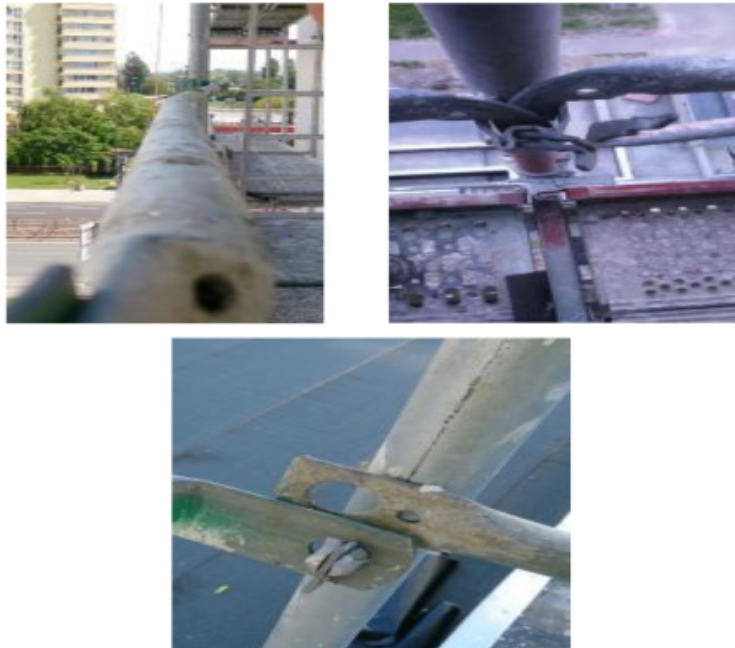
Gambar 21 Pagar Pembatas Bengkok, Salah Perakitan, Kopling Pagar Rusak
