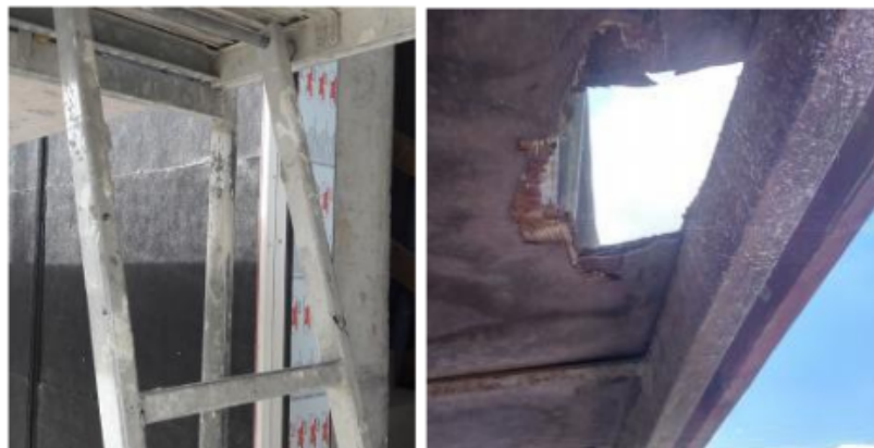
Gambar 22 Tidak ada anak tangga, Platform lapisan kayu hancur
