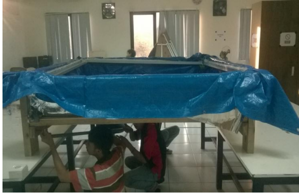
Gambar IV.22: Pemasangan tenda plastik pada wadah penampungan air baku dan rangkaian pipa aliran air
