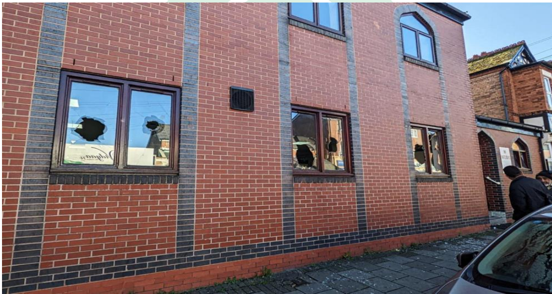
Gambar 1 kerusakan masjid di Sparkhill, Birmingham akibat serangan
