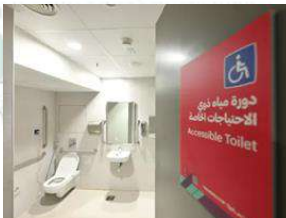
Gambar 4. 3 Toilet Khusus Penyandang Disabilitas
