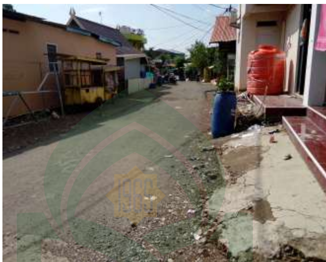
Gambar 13, Kondisi Jaringan Drainase di Lokasi Penelitian
