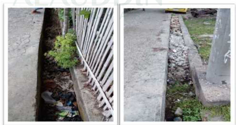
Gambar 6. Kondisi Jaringan Drainase
