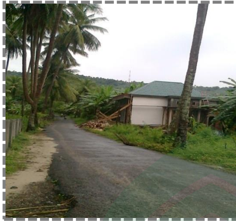
Gambar 10: kondisi Jalan Aspal
