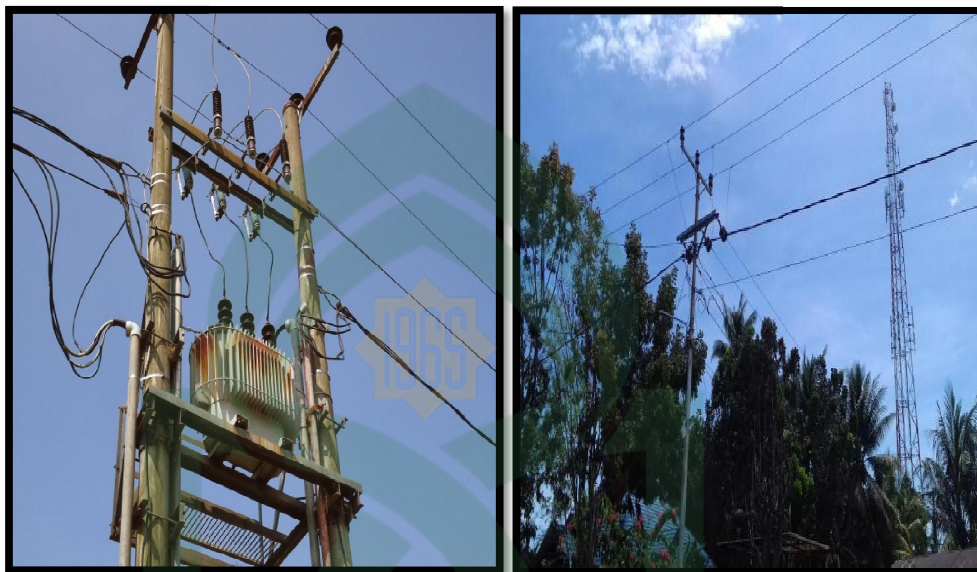
Gambar 16 Jaringan Listrik Di Kabupaten Bantaeng
