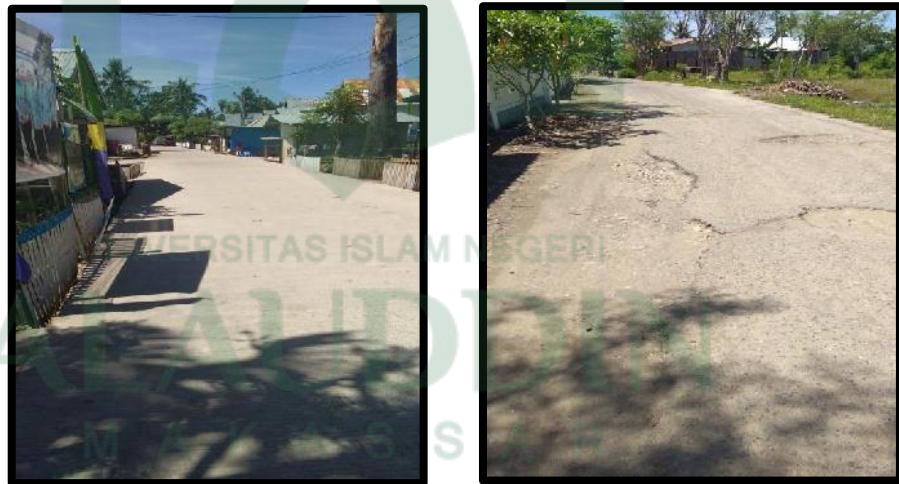
Gambar 3. Kondisi Jalan di Lingkungan Rangas Pabesoang
